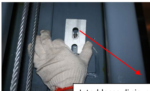
Interblocco di sicurezza
